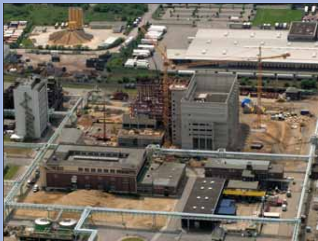
Ein Meilenstein modernster Umwelttechnik – Das Ersatzbrennstoff-Kraftwerk erzeugt nach Inbetriebnahme Ende 2008 aus energiereichen organischen Rohstoffen Dampf und Strom.
