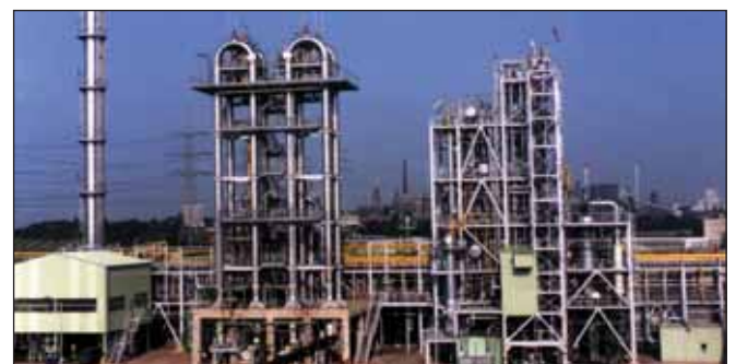
Die Masse-Polypropylen-Anlage im Werksteil Hürth. Charakteristisch für diese Anlage sind die weithin sichtbaren „Loop-Reaktoren“ links im Bild. Propylen, das hier hergestellt wird, ist ein vielverwendeter Kunststoff mit breitem Anwendungsspektrum.
