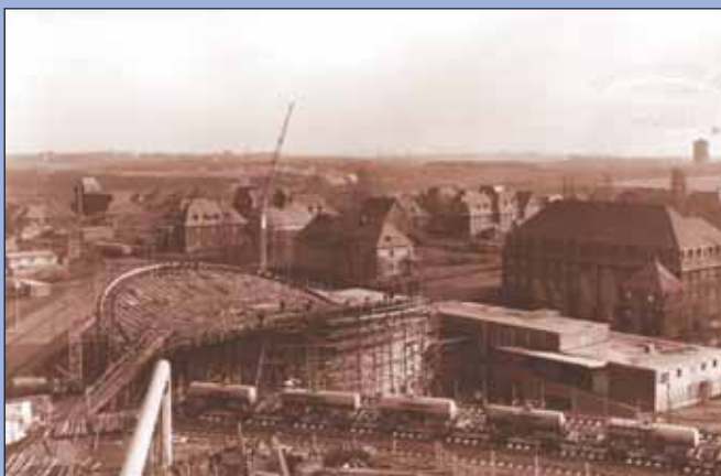
Das Feierabendhaus im Bau; aufgenommen 1956 vom Bereich der Phosphorbetriebe. Links die Werkszufahrt. Das größere Haus rechts ist die Schule von Knapsack. Links davon stehen die Häuser der „Oberbeamtenkolonie“, einer Werksiedlung, die für leitende Ingenieure und Chemiker der Aktiengesellschaft für Stickstoffdünger erbaut worden war. Weiter links die evangelische Kirche von Knapsack. Im Hintergrund ganz rechts der 1980 gesprengte Wasserturm der Gemeinde Hürth.
