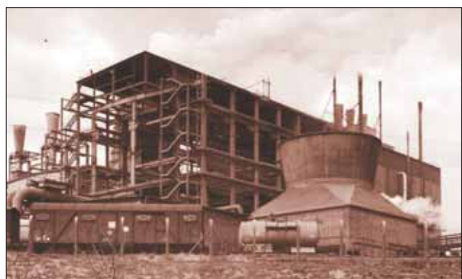
Das Phosphorofenhaus wird für den dritten Ofen erweitert und erreicht damit seinen endgültigen Umfang. Die Aufnahme vom 18. April 1963 entstand bei der Herrmann-Josef-Straße, später Industriestraße, im Ort Knapsack.
