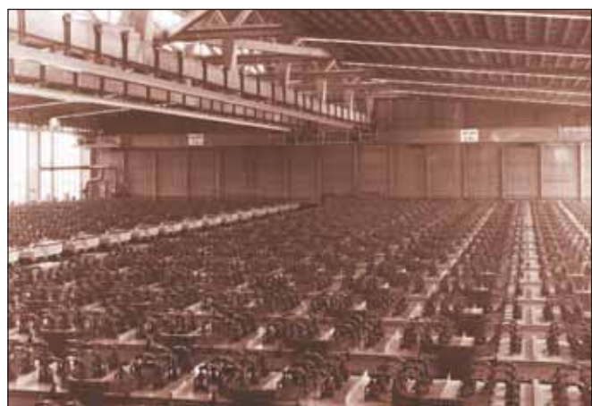
Der Zellenaal in der Chloralkali-Elektrolyseanlage im Werksteil Hürth am 16. November 1962. Die Halle hat eine Spannweite von 43 Metern und war damals vor späterer Erweiterung 65 Meter lang. Der Blick geht über zahllose, gleichförmige Elektrodenköpfe, die paarweise durch stromführende Kupferschienen verbunden sind. Salz wird als konzentrierte wässrige Lösung durch die Elektrolysezellen geleitet und in Chlor, Natronlauge und Wasserstoff umgewandelt.
