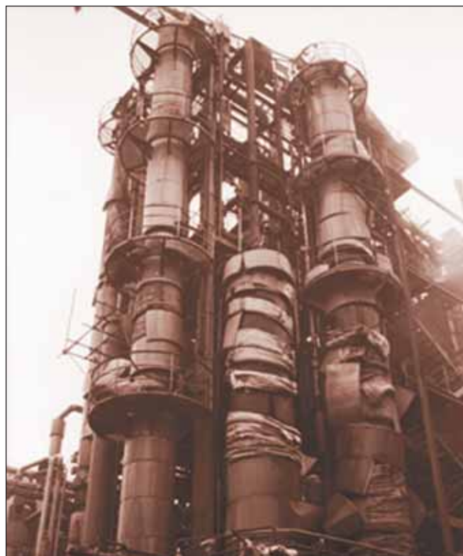
Drei Tage nach der Explosion in der VC-Anlage (EDC-Spaltanlage) entstand am 10. Juli 1974 diese Aufnahme. Die Beschädigungen sind deutlich zu sehen.
