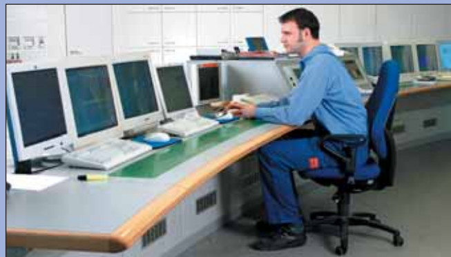
Mitarbeiter in der Energieleitzentrale der InfraServ Knapsack steuern die Versorgung der Produktionsbetriebe.
